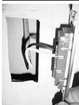
●コンセントの内部
