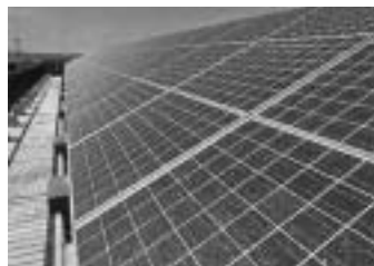
太陽光発電所
